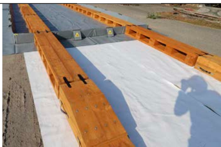
Záchytná vana s dřevěnými nájezdovými rampami
